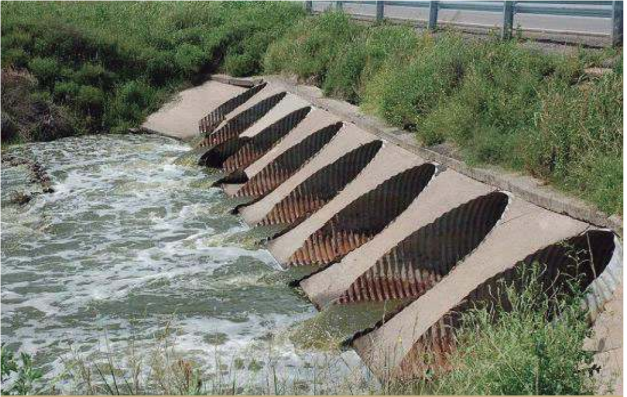
Un ingreso de agua por el canal de la laguna Cuero de Zorro.
