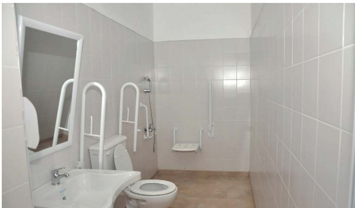
Sanitarios especiales para pacientes con dificultades de motricidad.
