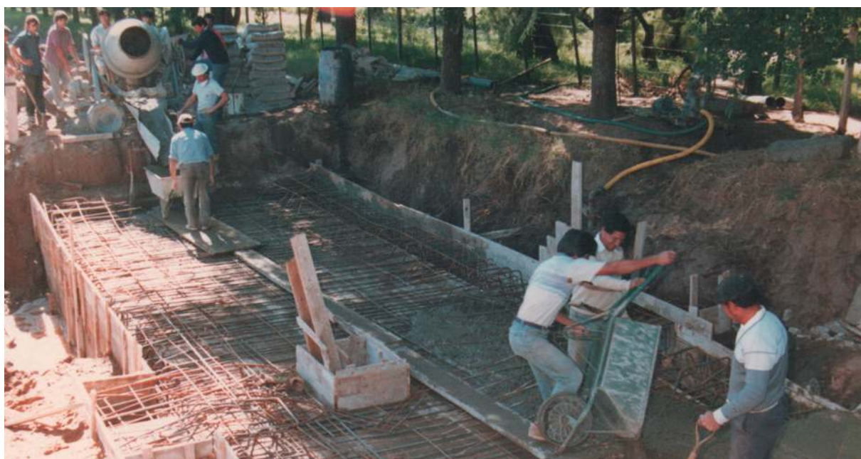
Desagües pluviales Avenidas Belgrano y Tomás Davis.
