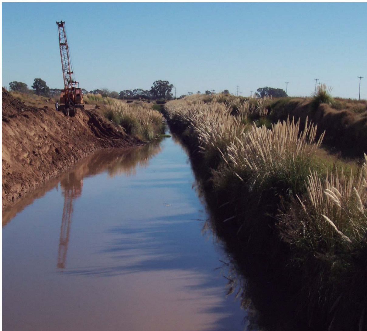
Ensanche del Canal revestido de la avenida Llambías hasta la Ruta Nº 5, 2004.
