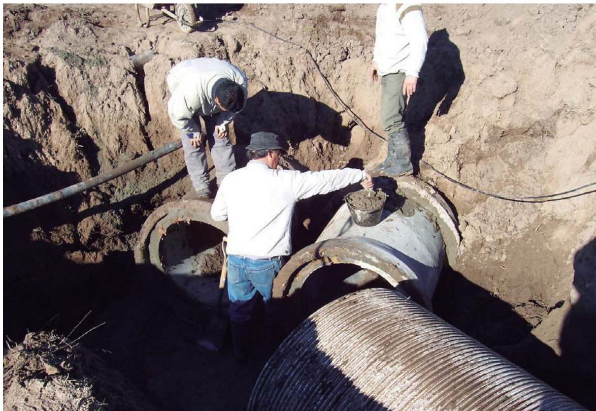
Conducto pluvial paralelo.
