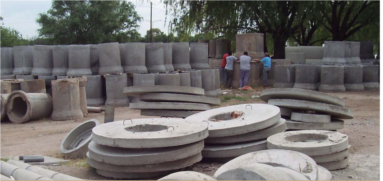
Fabricación en Coordinación Vial de cámaras de inspección, cañería de pluviales y laterales de alcantarillas.
