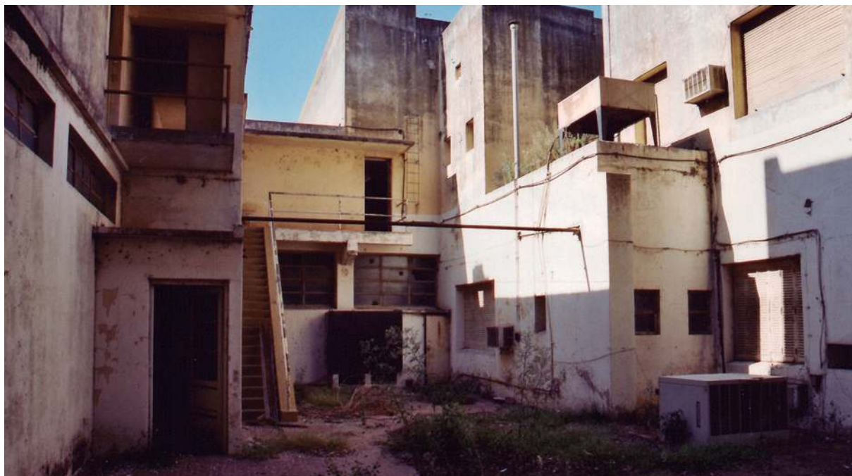
El patio de la aseguradora presentaba este aspecto de la desidia.
