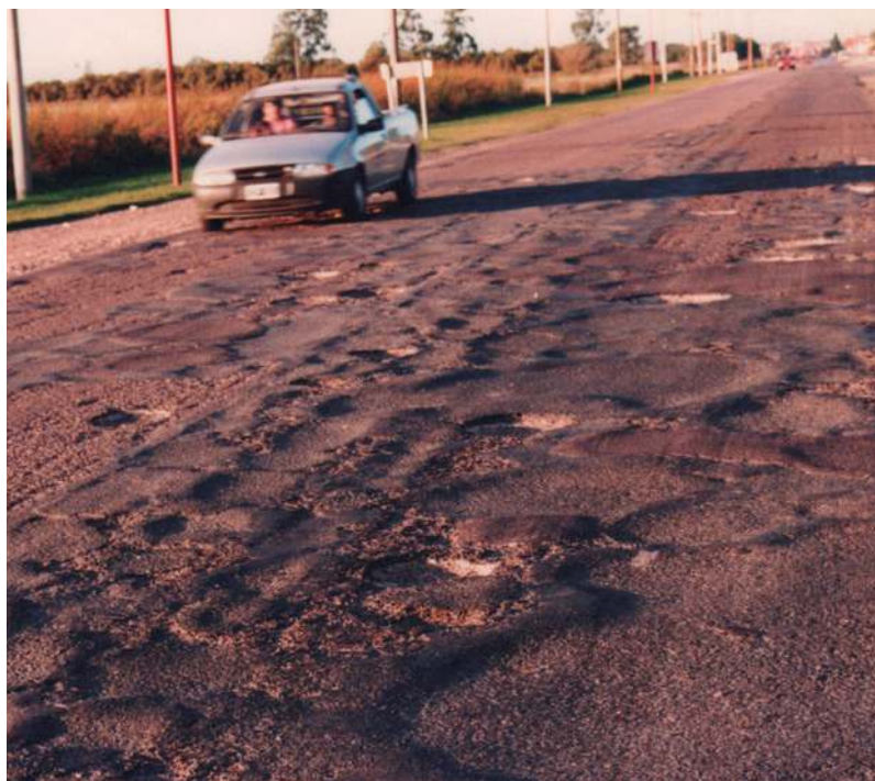
Calamitoso estado del acceso a la Ruta Nacional N° 33, 1999.
