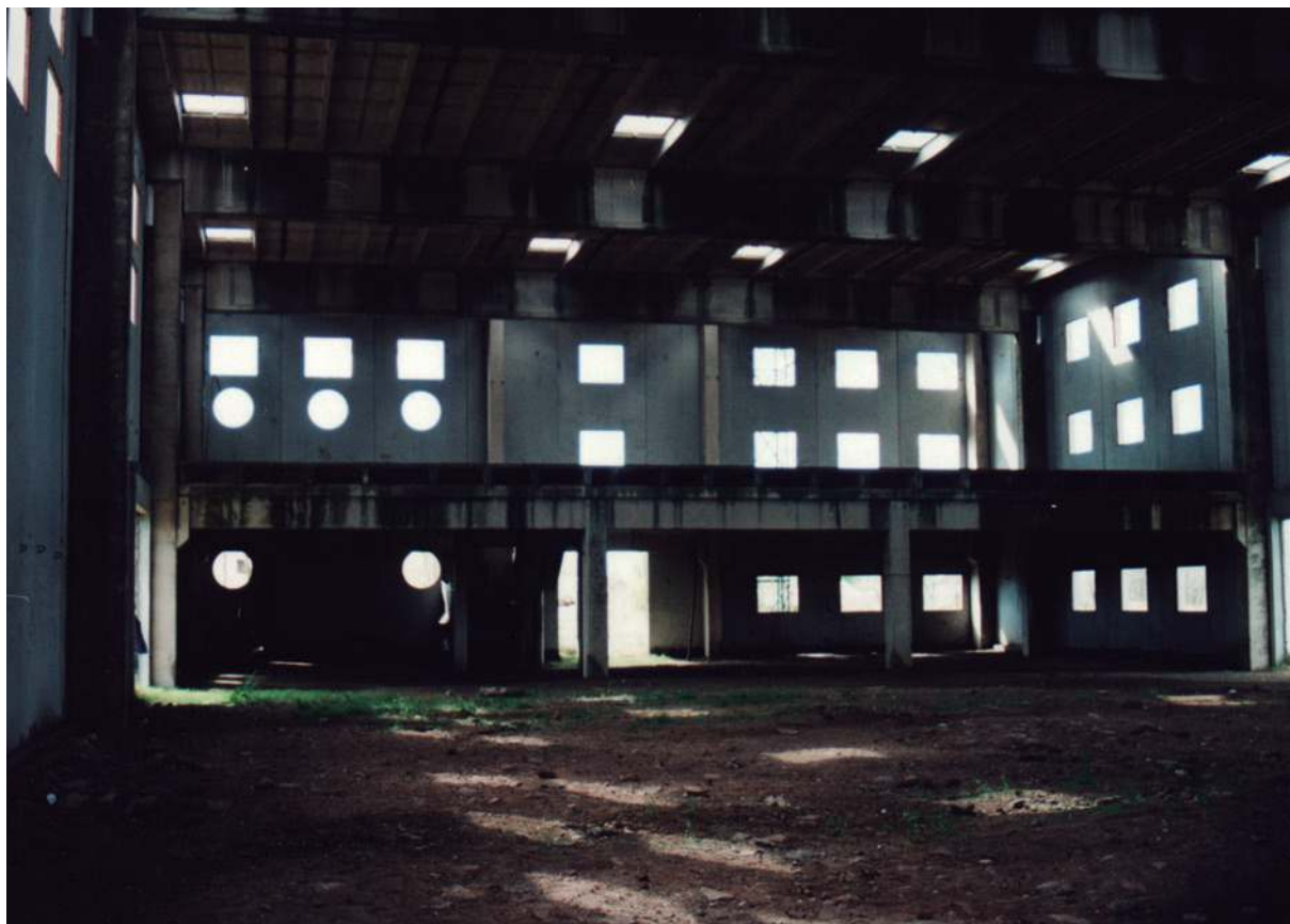
Interior del Polideportivo abandonado.
