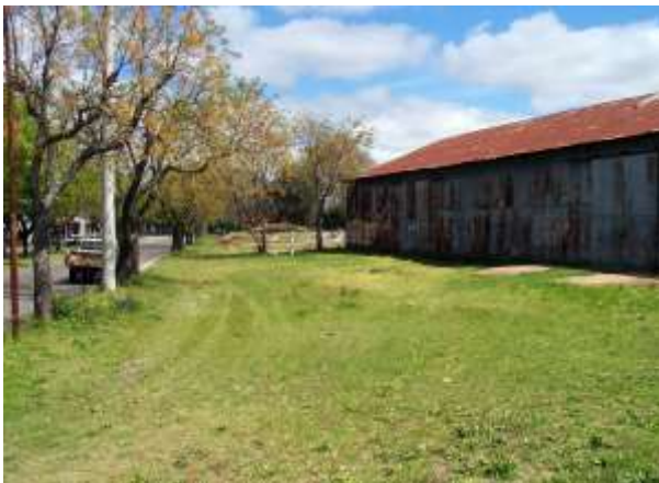
Estado del galpón antes de ser intervenido.
