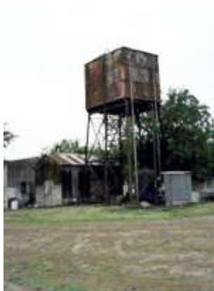
Tanque de reserva de agua, abandonado.
