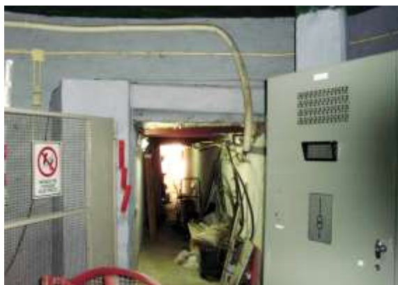
Subestación transformadora de la Cooperativa de Electricidad de Trenque Lauquen.
